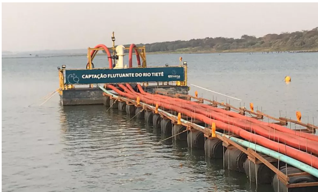
Plataforma flutuante de captação de água no rio Tietê, em Araçatuba: “mais tranquilidade no abastecimento” — Foto: Divulgação
